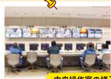
中央操作室の様子
