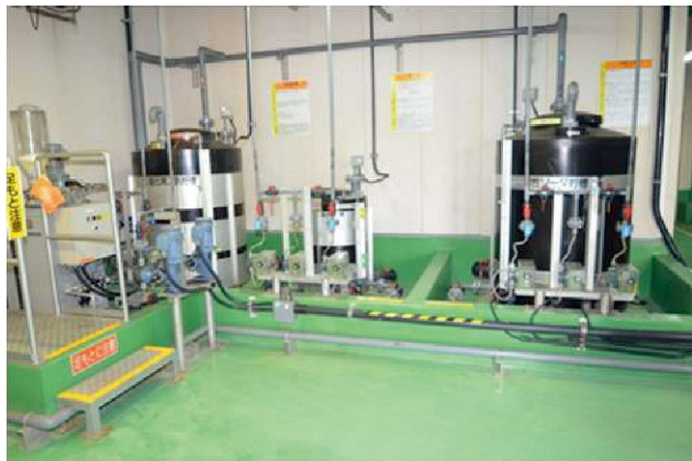
薬品タンクヤード
