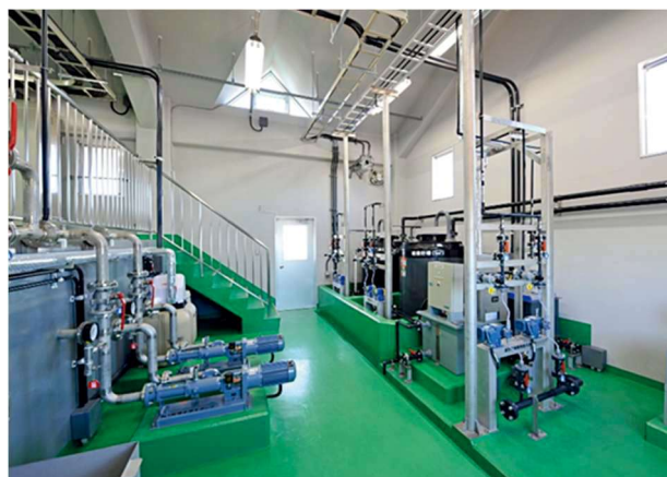
浸出水処理設備
