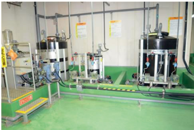
薬品タンクヤード
