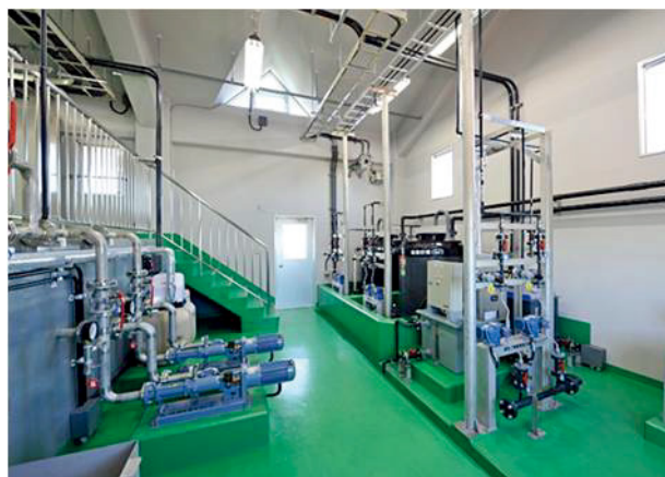
浸出水処理設備
