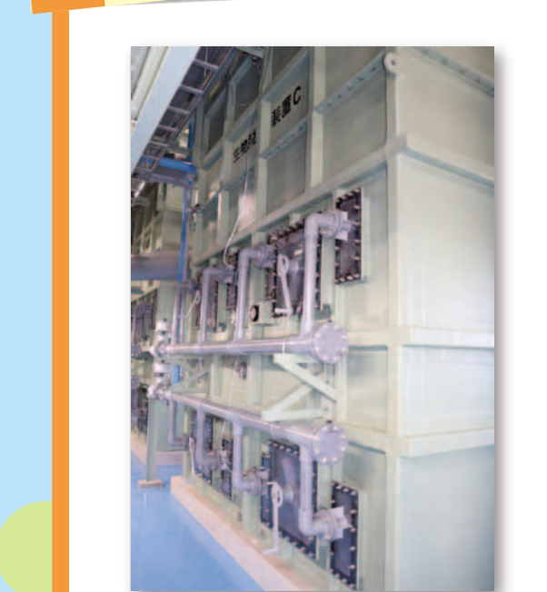
⑥生物脱臭装置
