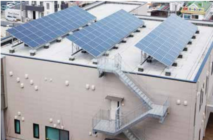
太陽光発電設備（30kW）
