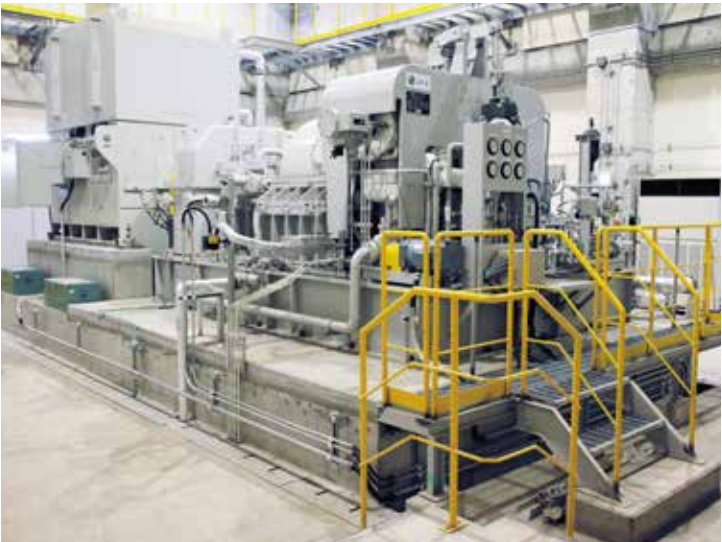
蒸気タービン発電機 ボイラより高圧蒸気溜めを経由した蒸気を利用して発電します。発電した電気は施設内及び施設外周辺施設に利用し、余った電気は電力会社に売電します。
