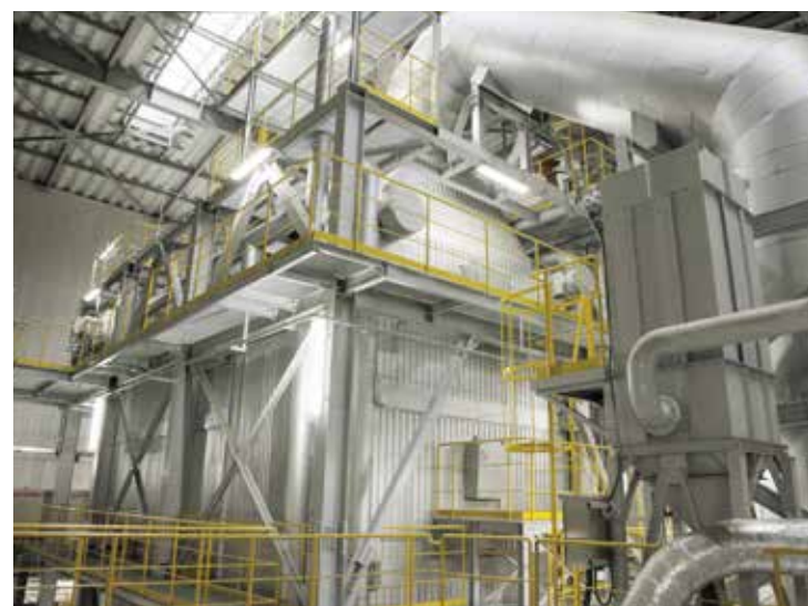
ボイラ ガス化溶融炉から送られた燃焼ガスの熱エネルギーを蒸気で回収します。
