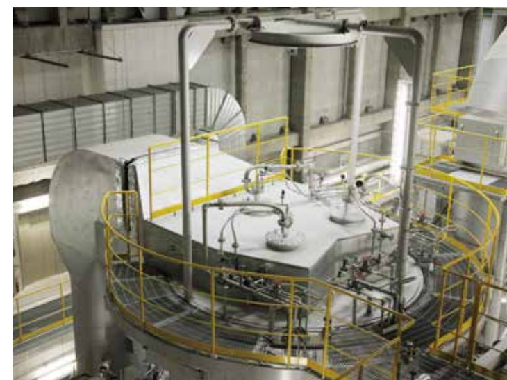
苛性ソーダ反応塔 排ガスに含まれる塩化水素、硫黄酸化物等を苛性ソーダで洗浄することにより中和処理します。
