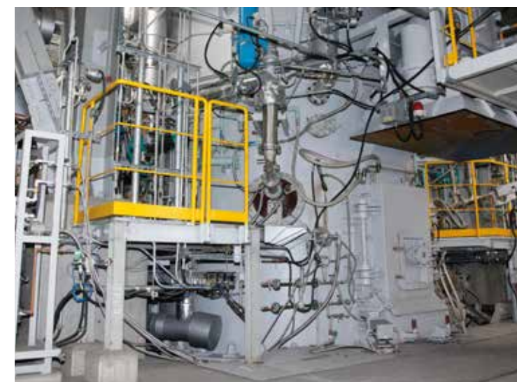
ガス化溶融炉 2炉ある溶融炉で1日297トンのごみをガス化・溶融処理します。
