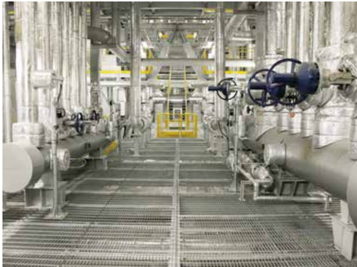
高圧蒸気溜め・低圧蒸気溜め ボイラで作られた蒸気は、写真右手前の高圧蒸気溜めで各使用先に分配されます。一部の蒸気は減温減圧され、写真左手前の低圧蒸気溜めに行き、場内外の余熱利用として活用します。
