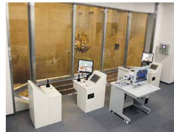
ごみクレーン操作室
