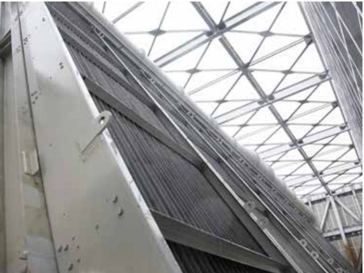
タービン排気復水器 蒸気タービンで発電用として使用した蒸気を、大きなファンで空気を送り、蒸気を冷やして温水に戻します。この温水は、排気復水タンク、復水タンクを経て再びボイラへ送り蒸気に戻します。
