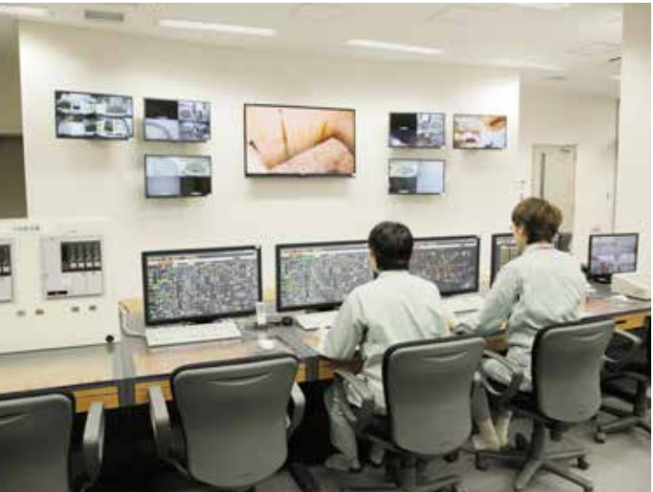
中央操作室 壁面のITVモニターでプラントの運転状況を表示し、オペレーターステーション(コンピュータ)でプラントの集中監視・操作を行います。
