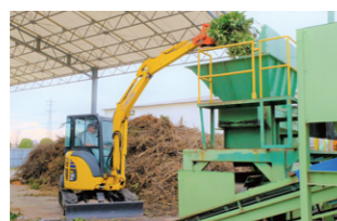
2-1 一次破碎 一次破碎機で粗く破碎します。
