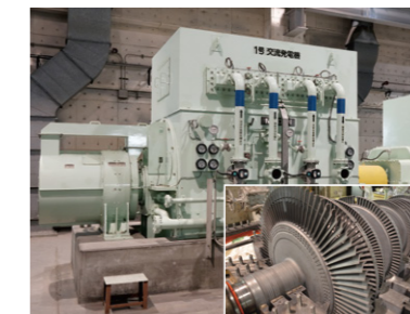
蒸気タービン発電機
