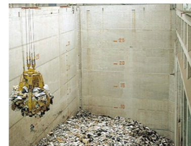
ごみピットとごみクレーン
